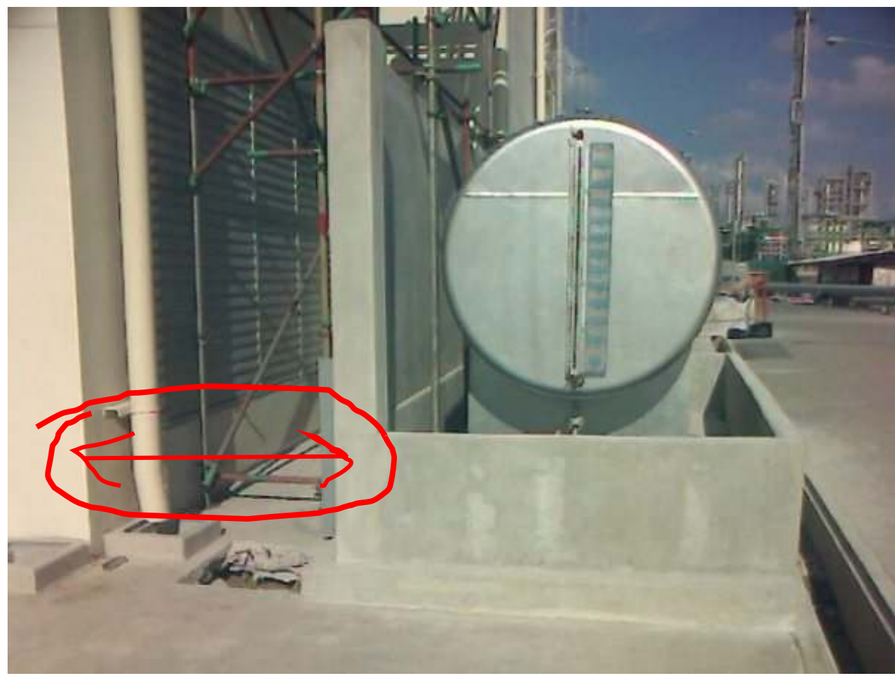
Air Outlet Louver
